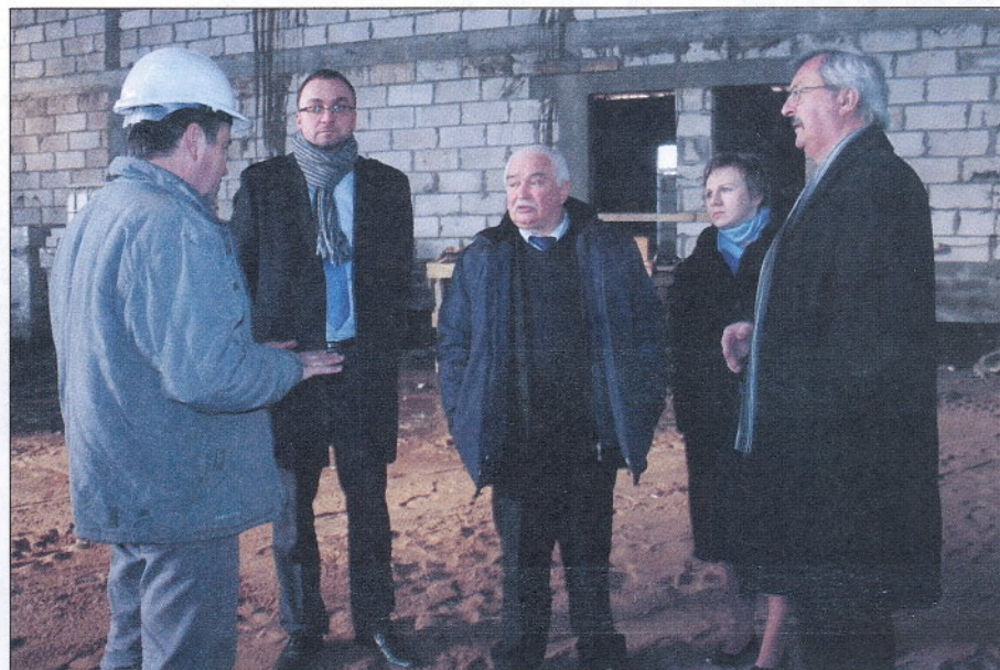
Goście wizytujący budowę hali w Wielkim Klinczu byli pod wrażeniem zaawansowania prac.
