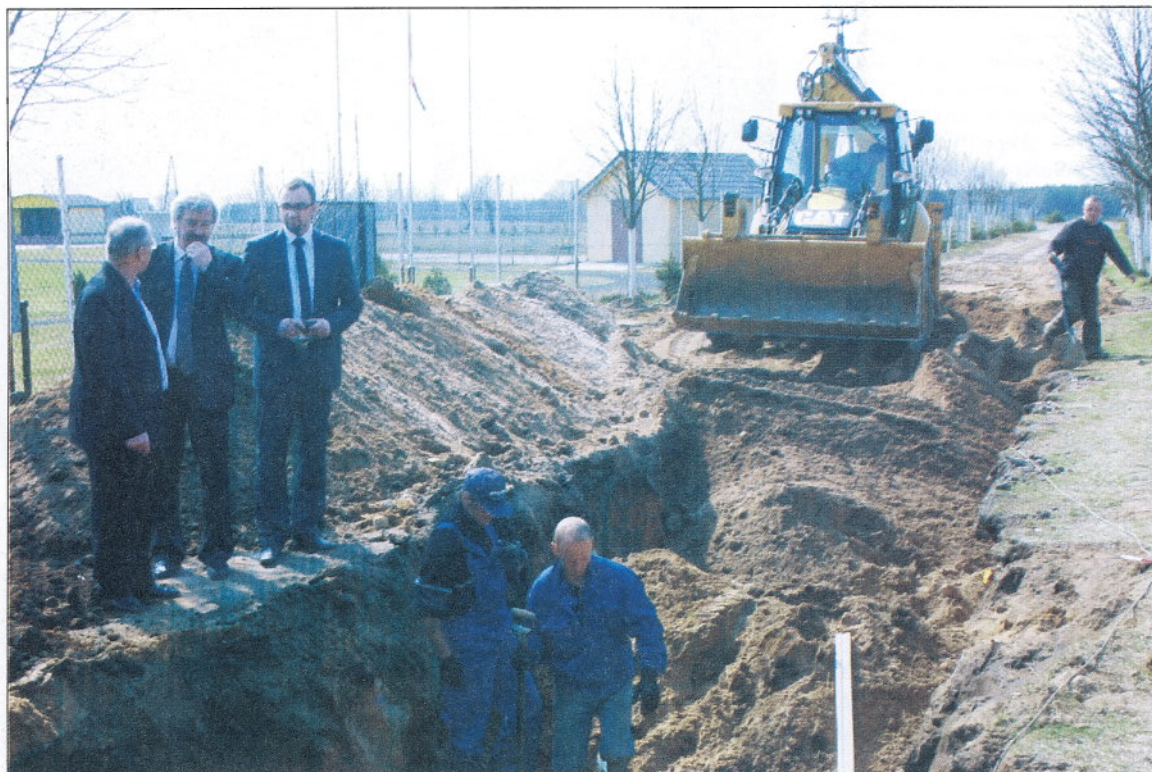
Wójt Waldemar Tkaczyk, z-ca wójta Tomasz Nadolny oraz Radny Gminy Kościerzyna Mirosław Hapka wizytowali przebieg prac związany z budową sieci kanalizacyjnej w Kornem.
