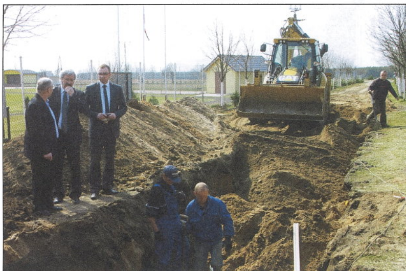
Wójt Waldemar Tkaczyk, z-ca Tomasz Nadolny oraz Radny Mirosław Hapka wizytują postępy prac budowy kanalizacji w Kornem.
